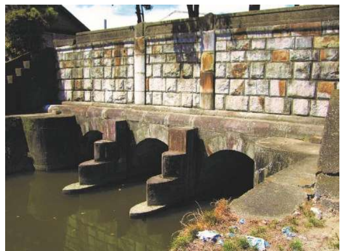
12. 郡築二番町樋門(斜めより撮影)
